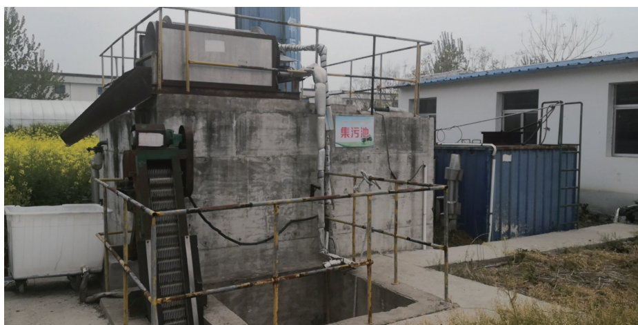
▲安欣牧业羊场污水处理厂集污池
