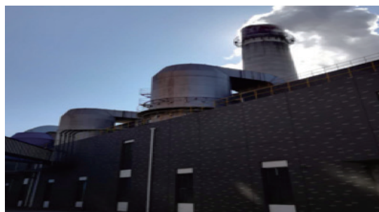
图：脱硫除尘设备
