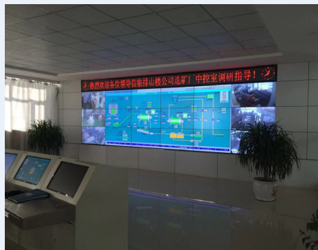
公司自动化控制室
