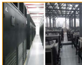
机房专用空调
