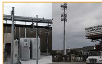
通信基站户外柜
