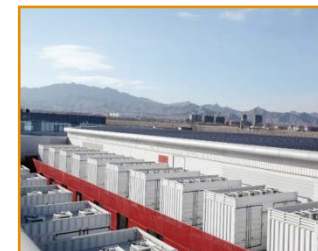
间接蒸发冷却机组
