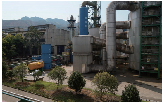
◆ 离子液法脱硫吸收塔
