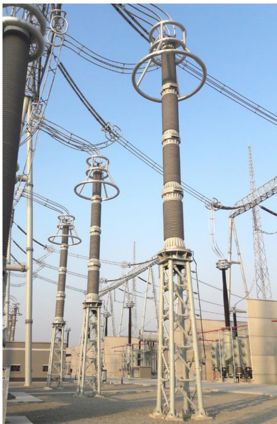
1000kV 复合外套避雷器临沂站
