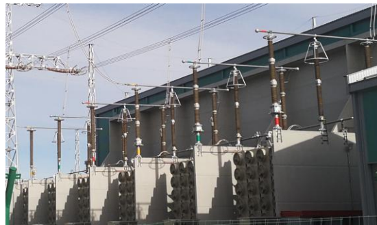
750kV 瓷外套避雷器伊克昭站
