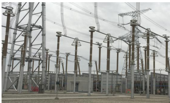
750kV 复合外套避雷器沙洲站
