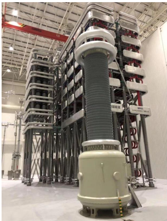
500kV 直流断路器用避雷器--张北柔直工程
