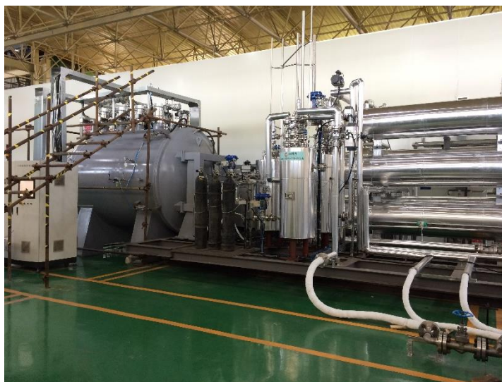
图：热氦检漏设备
