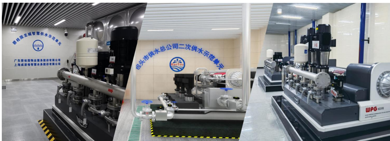
广东碧桂园龙城智慧供水示范单元
