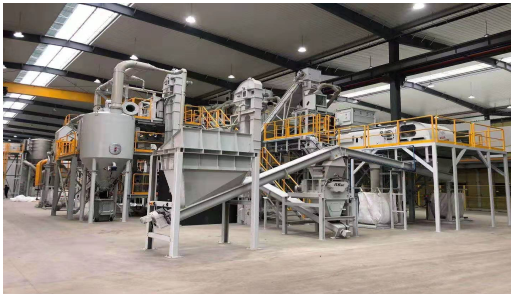
废电冰箱拆解线
