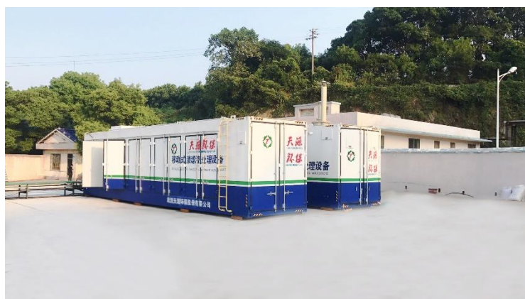
岳阳市花果畈生活垃圾填埋场渗滤液处理服务项目实景图
