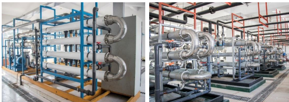
超滤膜集成装置设备实拍图
