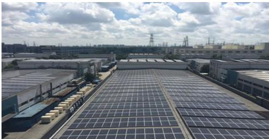
上海东开置业有限公司新飞园、锦昔园屋顶分布式光伏电站项目
