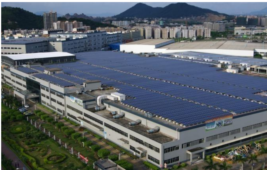
珠海25MWp分布式发电项目--伟创力珠海工业园太阳能光伏发电项目
