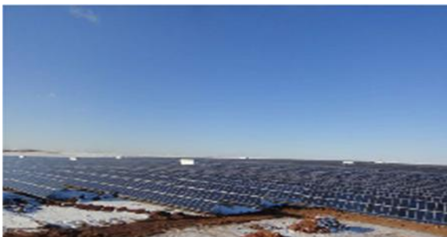
国电蒙电乌兰察布市四子王旗40MWp光伏电站工程、二期60MWp光伏电站工程（2011年）
