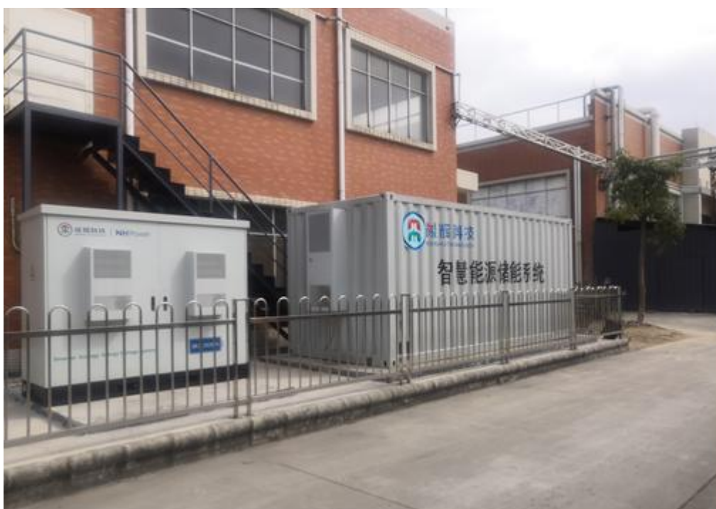
珠海用户侧500KW/1MWh智慧能源储能系统梯次利用示范项目
