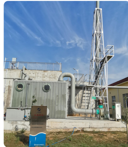
◆ 废气排气筒与配套空气质量检测平台
