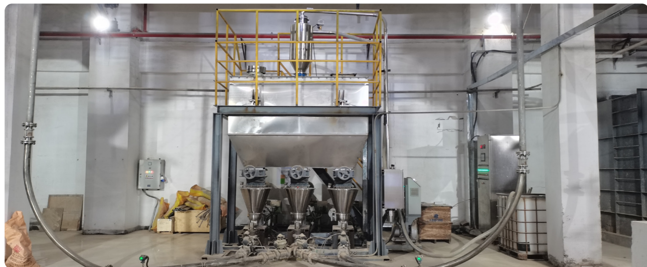
◆ 炉内 PNCR 高分子脱硝系统
