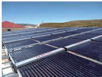
改造后的太阳能电辅热锅炉
