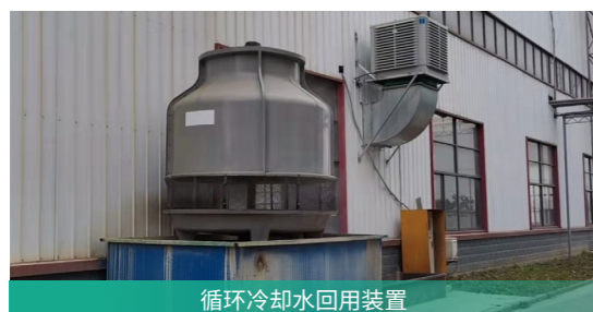
循环冷却水回用装置
