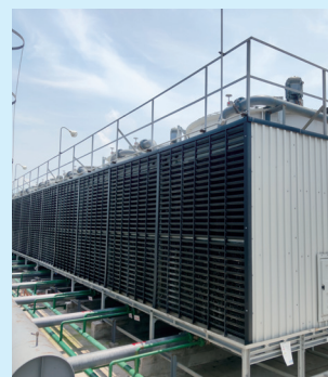
重庆国际复合材料股份有限公司中央空调和工艺循环水节能改造项目
