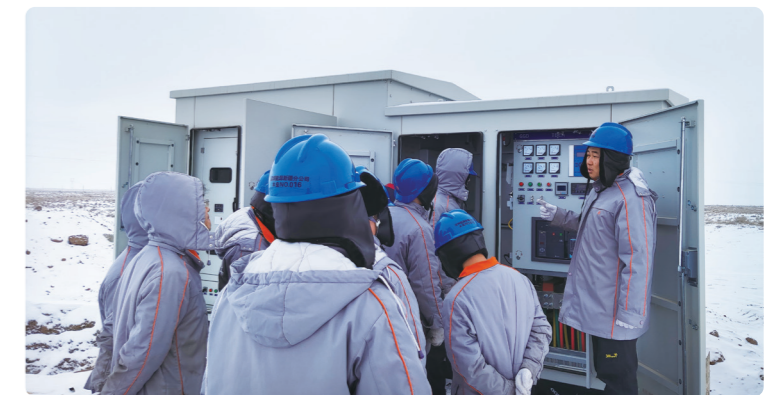
深能木垒风电智能化综合平台调试
