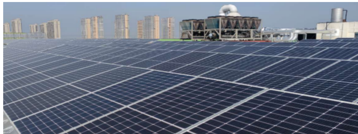
屋顶光伏发电
