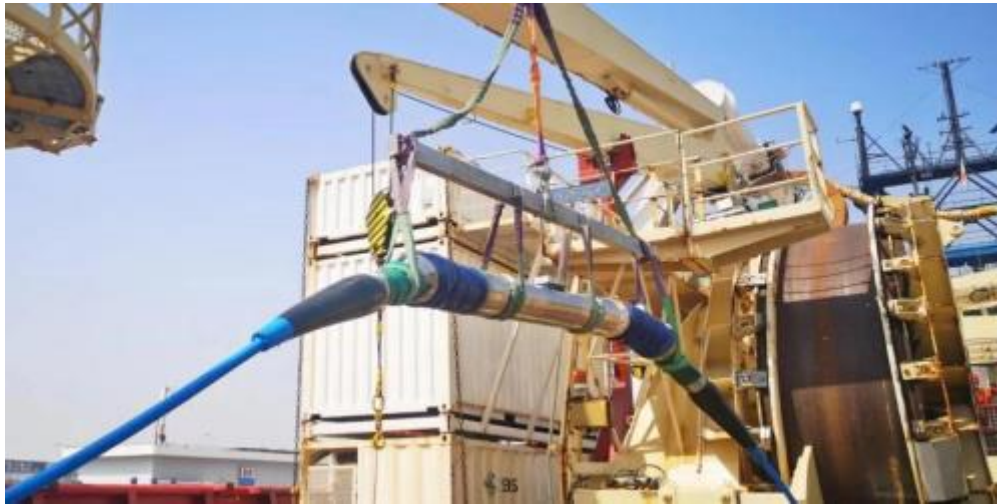
图 8 全球首个 16 纤对中继海底光缆系统
