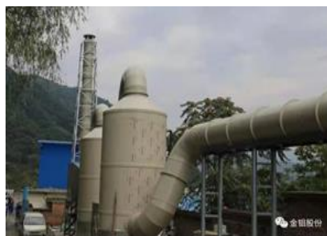
药库废气治理设施
