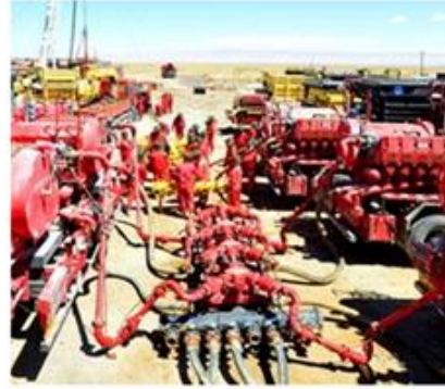
油田压裂系统装置
