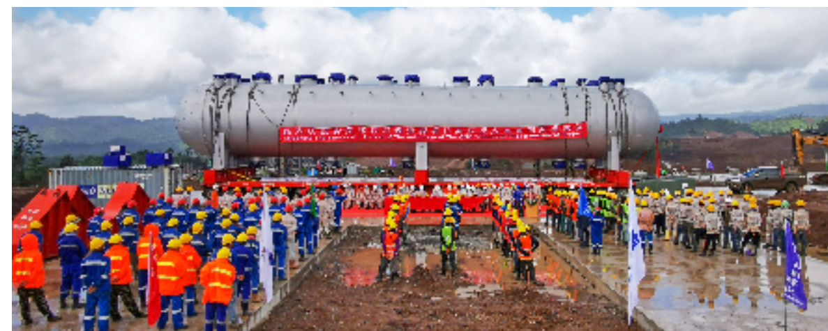
青美邦印尼镍资源项目高压浸出核心设备到港就位
