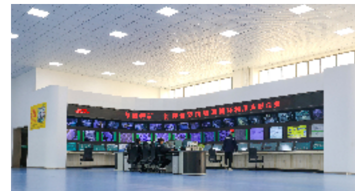
废弃钨资源回收利用改扩建项目中控平台
