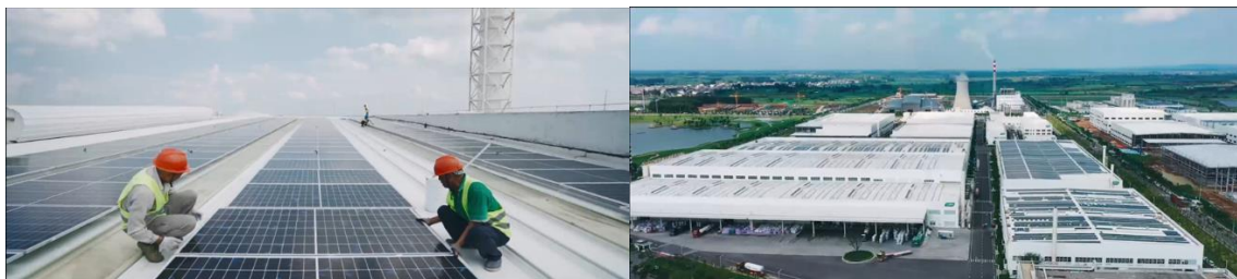
图：安徽工厂光伏项目
