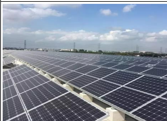
上海青浦 1.35MW 工商业项目
