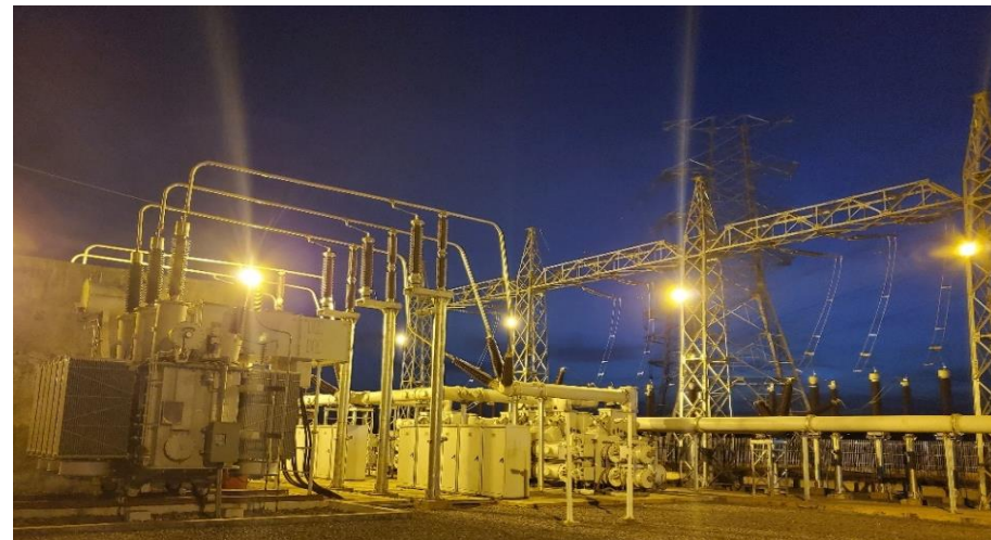
乌干达工业园区输变电项目132kV变电站送电成功
