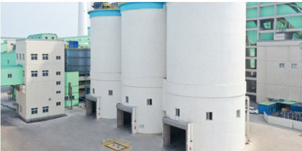
恒力炼化煤粉灰回收系统
