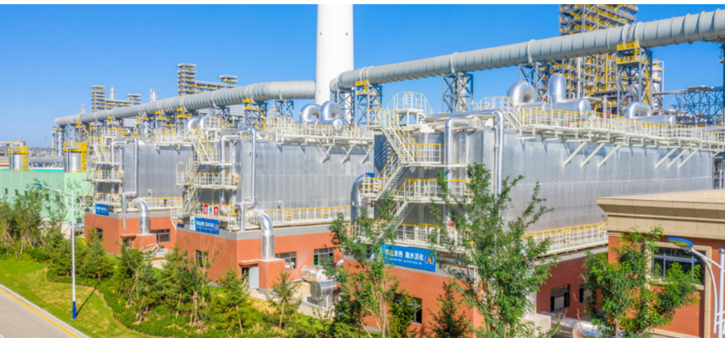
恒力石化海水淡化装置
