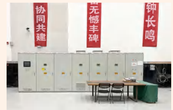
梅州抽水蓄能电站中的公司励磁产品
