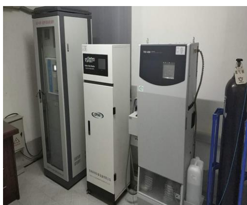
污水总排口在线监控设施
