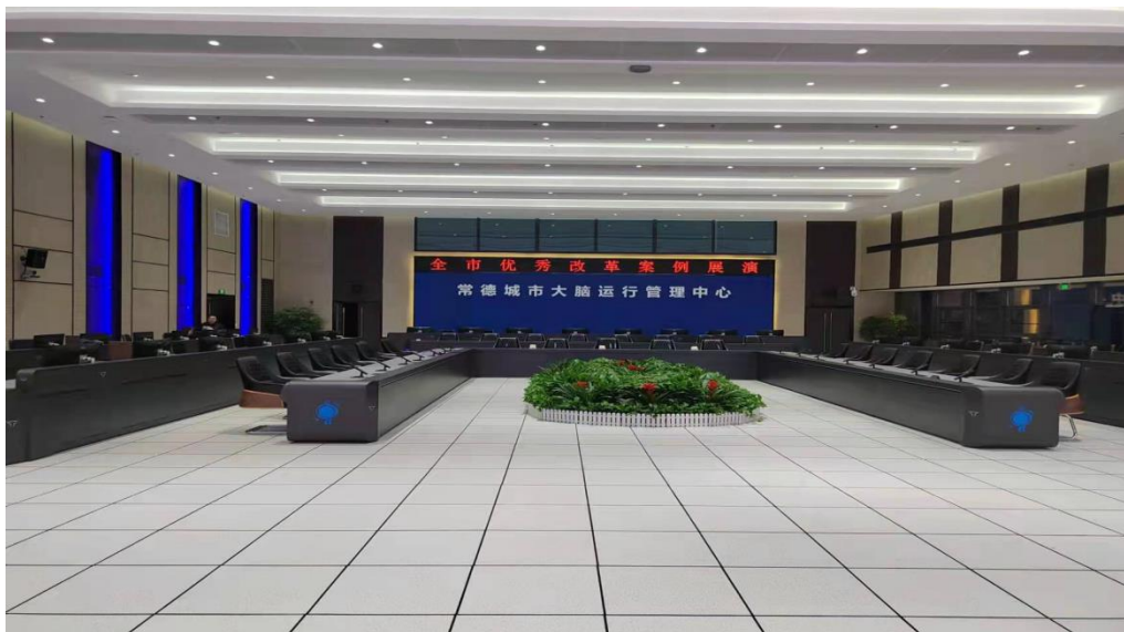
图：常德智慧城市——城市大脑运行管理中心
