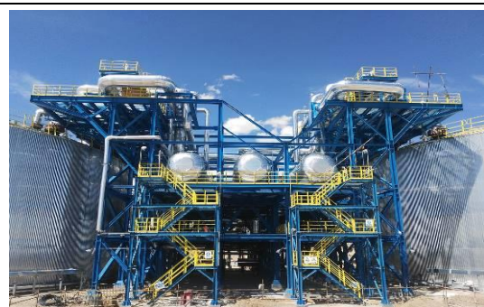
德令哈光热发电厂—油盐换热器
