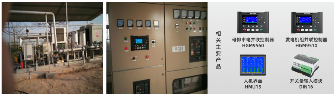
(10) 新能源光伏储能柴发混合供电
