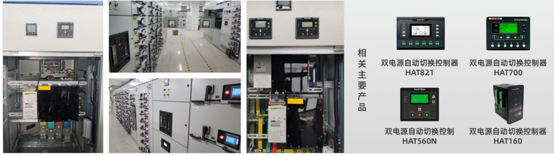
(8) 数据中心应急备用电源
