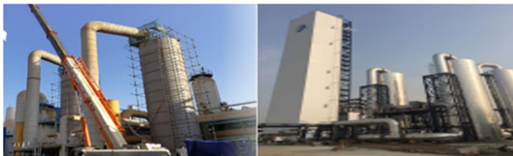
天安化工 5.2 万 Nm 3 /h 深冷空分装置
