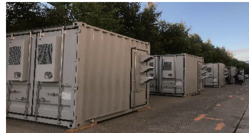
泰国国家发电局 5MW 储能项目
