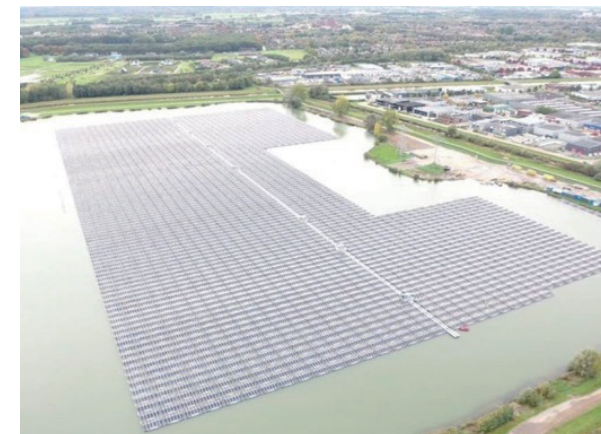
荷兰 14.5MW 漂浮电站
