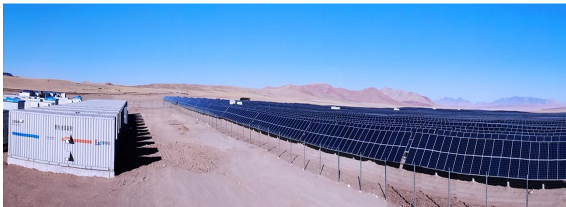
风电储能应用场景：
