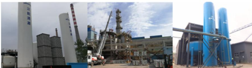
北京汉能清源 3200-93 变压吸附制氧装置
