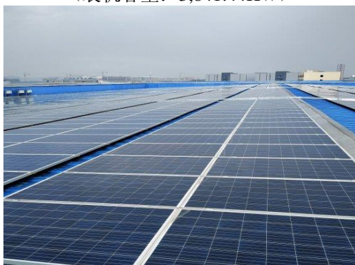
浙江康泰管业科技有限公司 分布式光伏电站项目 (装机容量：3,841.44KW)
