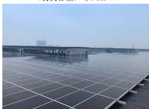
海盐凯特机械设备有限公司 分布式光伏电站项目 (装机容量：4,498KW)
