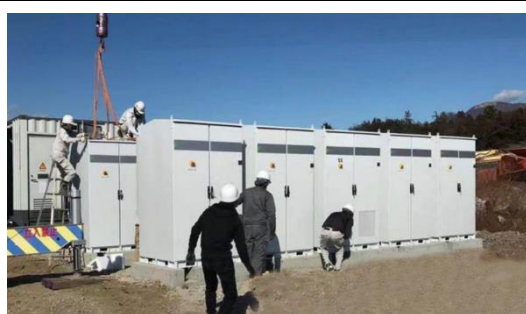
日本群馬 2.15MWh 储能电站
