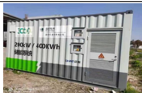
浙江温州 10MWh 储能电站
