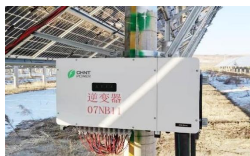
阜新 70MW 光伏发电电站
