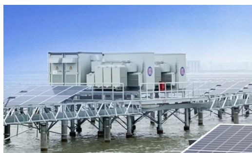
温州泰瀚 550MW 渔光互补电站
