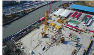
苏州河段深层排水管道系统工程 混凝土结构耐久性防腐技术质量检测、BIM咨询、基坑围护检测
