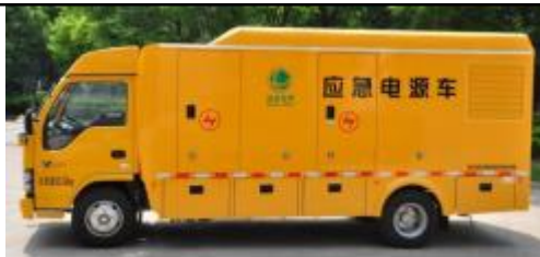
100-200kW 应急电源车
