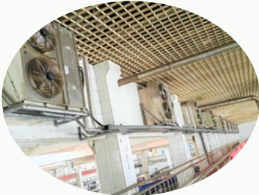
青岛啤酒五厂热泵设备
