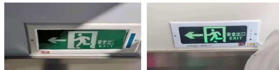
员工发现一处疏散指示牌破损
