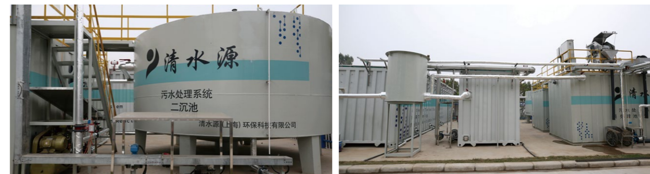
洛阳洛龙区300吨/天生活污水处理项目
