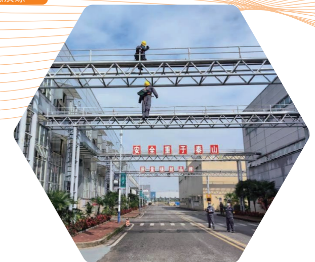
高处坠落事故应急演练
