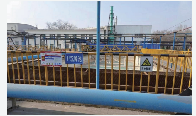
公司污水处理站
