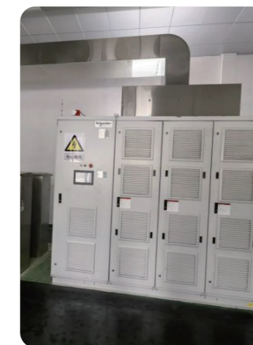
变频器水泵机组变频器
