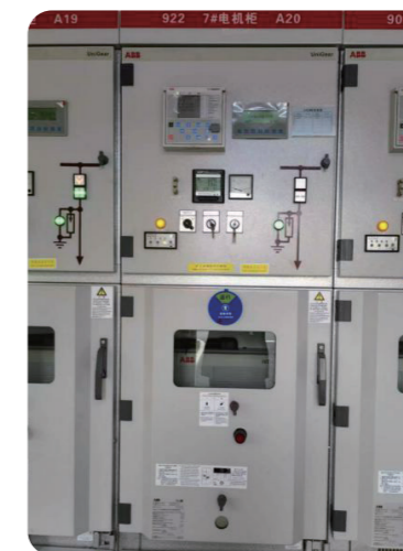
变频器水泵机组高压电出线柜
