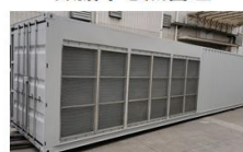
数据中心冷却系统
