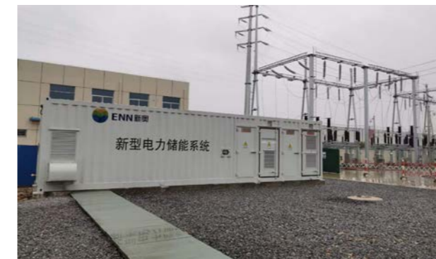
• 安徽宣城增量配电网储能项目
