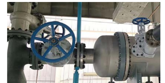
改造后增添的管壳式气水换热器
