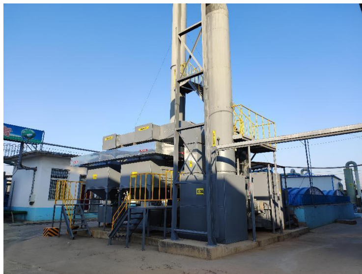
威远生化鹿泉制剂车间 VOC 设施改造后场景图
