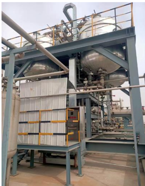
利民化学购置混醚树脂吸附系统，有效处理 苯醚车间产生的混醚尾气，实现达标排放
