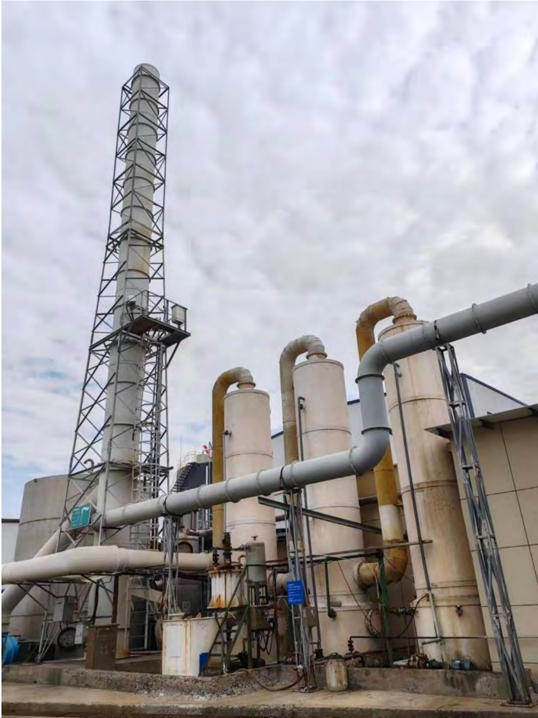
图4-11：污水处理设施或废气处理设施图片
