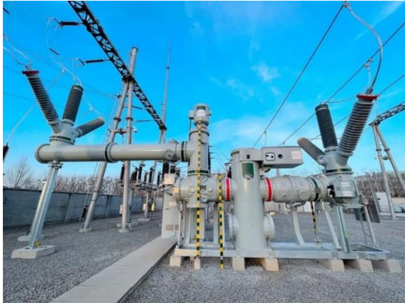
我国首台 126 千伏无氟环保 GIS 设备
