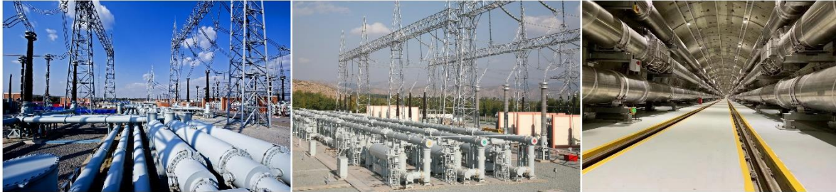
国内首套 1100kV GIS 产品应用于我国首条特高压示范工程—晋东南站
